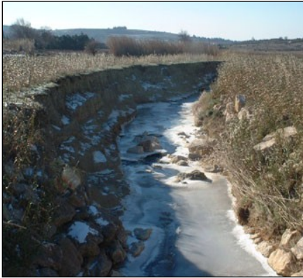
Erosion du talus interne de la digue rive gauche à l'aval du pont des Avons
