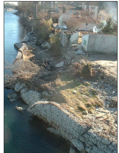
Erosion de berge et dégâts sur les protections à l'aval du pont de Remoulins
